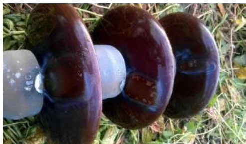
Sl. 3. Izolator nakon preskoka
