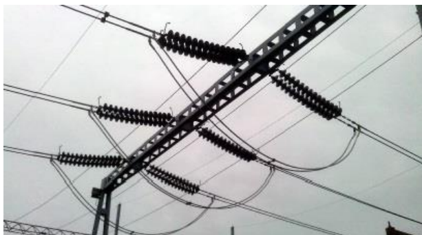
Sl. 5. Strujni mostovi na sabirnicama 220 kV
