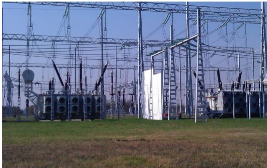
Sl. 1. Postrojenje trafostanice Novi Sad 3 naponskog nivoa 400kV/220kV/110kV
