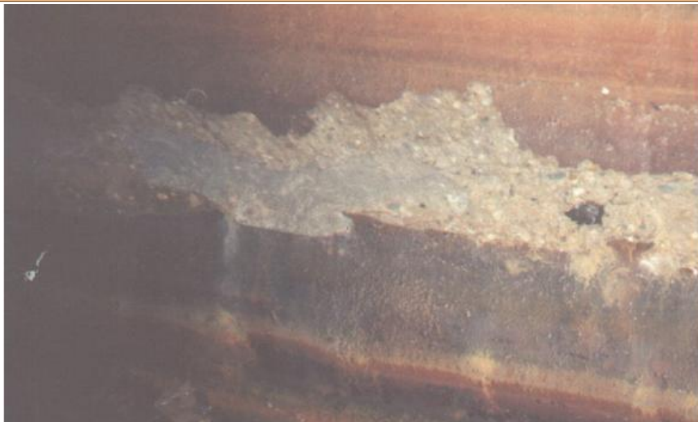
Slika 6. Oštećenje bokova kolektora na deonici ispod brane "3A" pre saniranja
