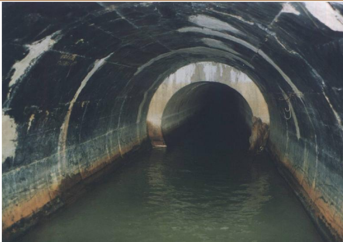
Slika 8. Suženje profila kolektora na saniranom delu kolektora
