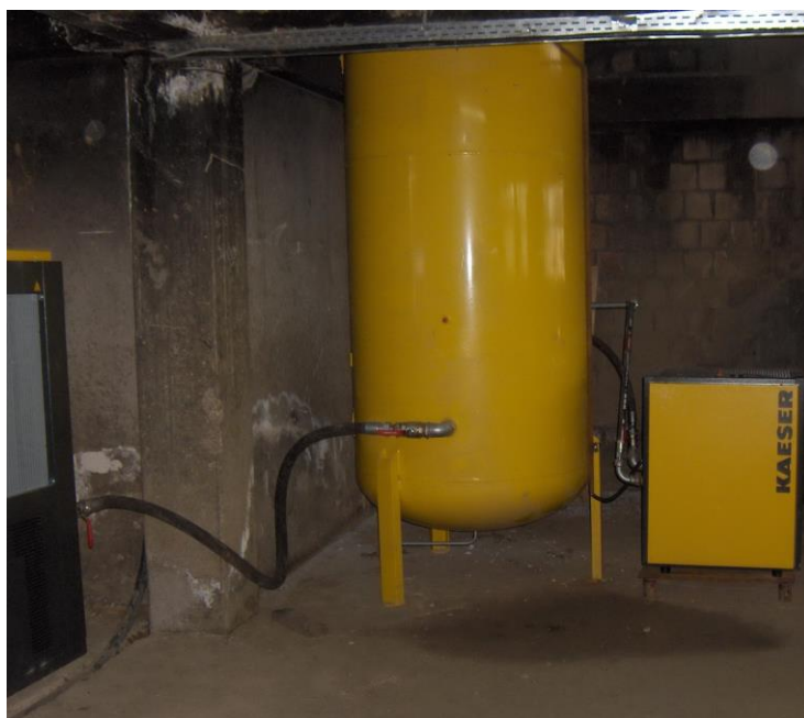
Sl. 3. Rezervoar i rashladni sušač u kompresorskoj stanici pogona Filtraže rudnika „Lece“
